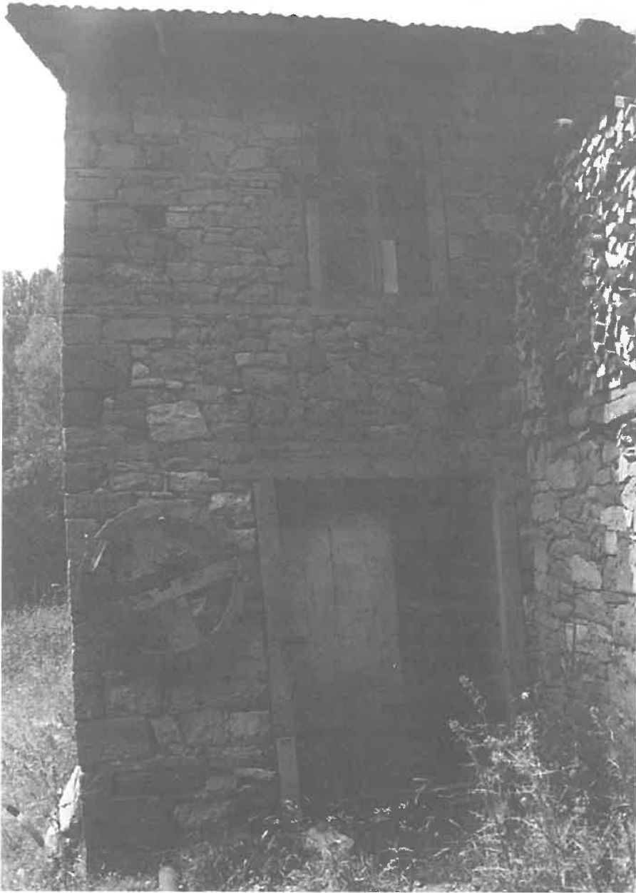
Φωτογρ. 9. Το νεροπρίονο του Ζαρκάδι στο Μέτσοβο. Στο ισόγειο οι τροχαλίες και οι μάντες, στον όροφο βρίσκονται τα μηχανήματα (κορδέλλα, πλάνη, κ.ά.) Έχει κτιστεί στις αρχές του 20αί.
